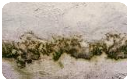
Figura 20. Presencia de humedad en pared por fuga de agua
