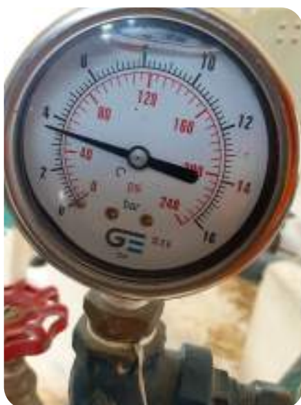
Figura 21. Manómetro registrando la presión del sistema de bombeo durante pruebas de presión Nota. Fotografía obtenida en campo, Estación de Bombeo Curitroje (E.B. Curitroje), 2024.
