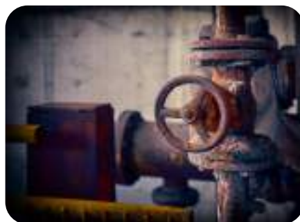
Figura 3. Falla en conexión de accesorio por corrosión
