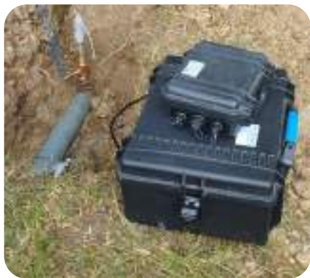
Figura 32. Transmisor 2 del correlador instalado en la tubería Nota. Fotografía obtenida en campo, Estación de Bombeo Curitroje, 2024.
