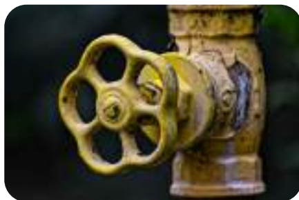
Figura 5. Válvula de paso desgastada
