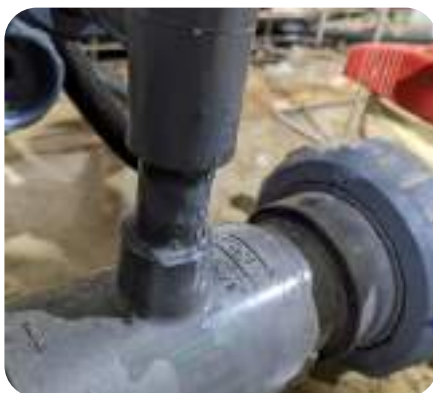
Figura 6. Fuga de agua por exceso de presión
