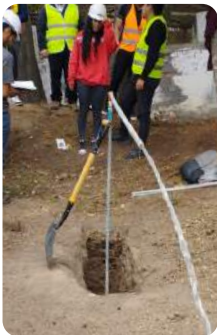
Figura 1. Simulación de fuga de agua Nota. Fotografía obtenida en campo.
