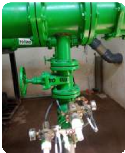
Figura 7. Válvulas de paso de sistema de riego
