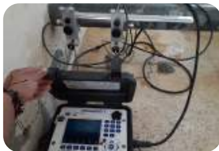
Figura 26. Caudalímetro ChronoFLO2 instalado y en funcionamiento
