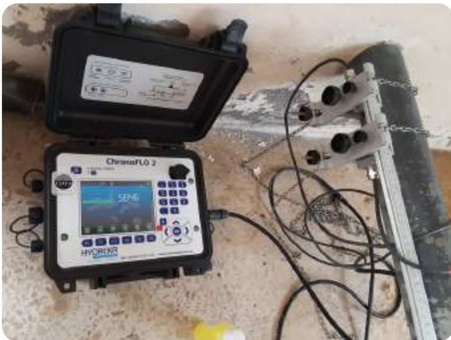
Figura 28. Caudalímetro ChronoFLO2 instalado y en funcionamiento
