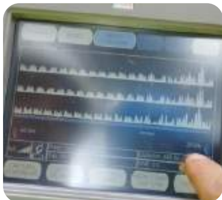
Figura 34. Correlador recibiendo la señal de ruidos de fuga de los transmisores Nota. Fotografía obtenida en campo, Estación de Bombeo Curitroje, 2024.
