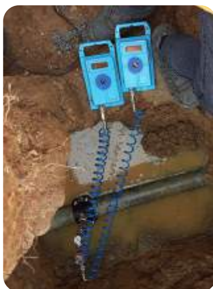
Figura 22. Data loggers registrando presión durante pruebas en el sistema hidráulico Nota. Fotografía obtenida en campo, Estación de Bombeo Curitroje (E.B. Curitroje), 2024.
