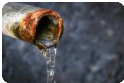
Figura 2. Falla en tubería por falta de mantenimiento
