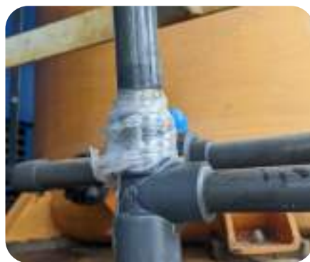
Figura 4. Fuga de agua en unión mal instalada Nota. Tomado de Power plant project activity for water treatment plant and checking equipment [Fotografía], por Vecteezy, 2020.
