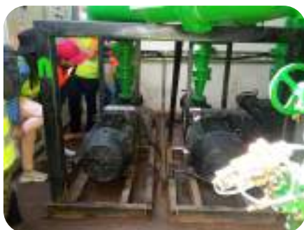
Figura 8. Bombas del sistema de impulsión
