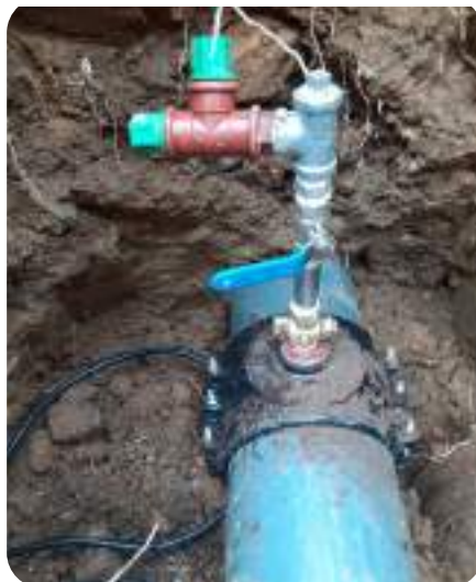
Figura 29. Collarín y tapón metálico instalados en la tubería
