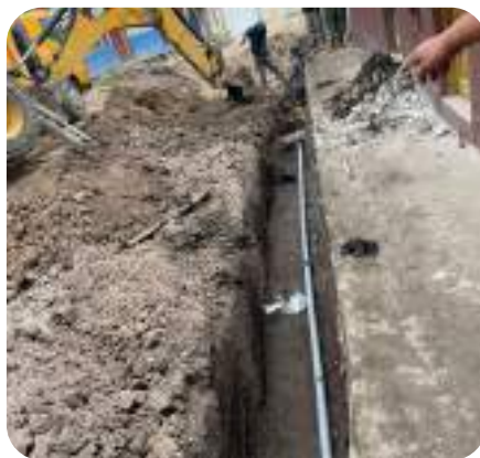
Figura 9. Ruptura de tubería por mantenimiento Nota. Fotografía obtenida en campo por el autor, 2024.
