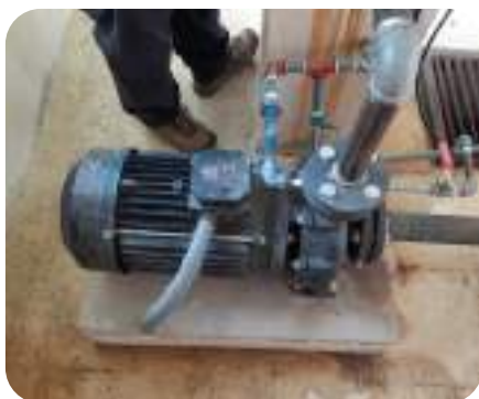
Figura 23. Bomba 2 marca General Pumps en funcionamiento
